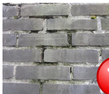
Figuur 34 Slecht gevoegde muur
